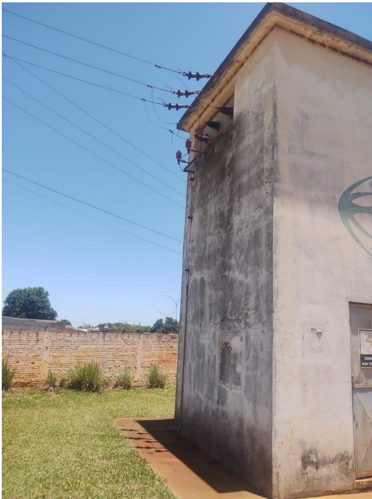
Figura 18. Vista posterior cabine de medição
