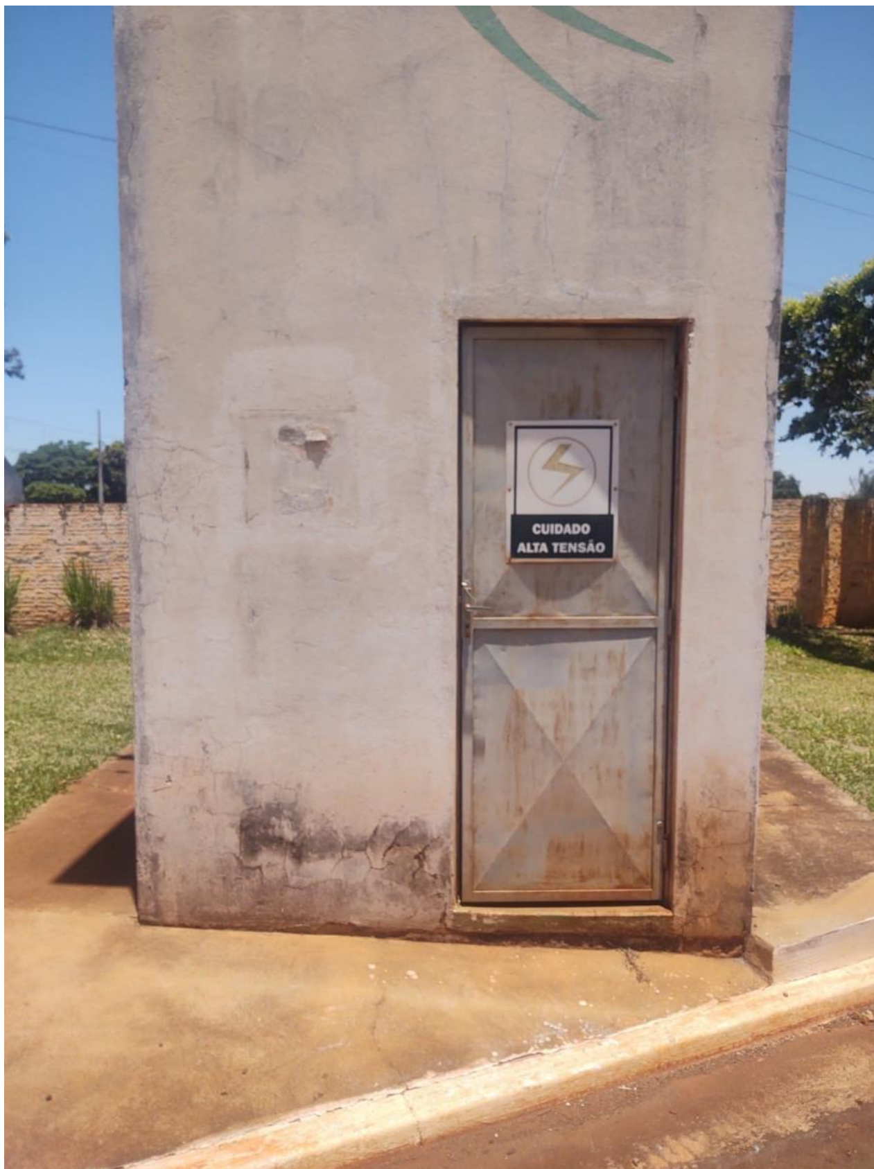
Figura 19. Vista lateral cabine de medição (porta)
