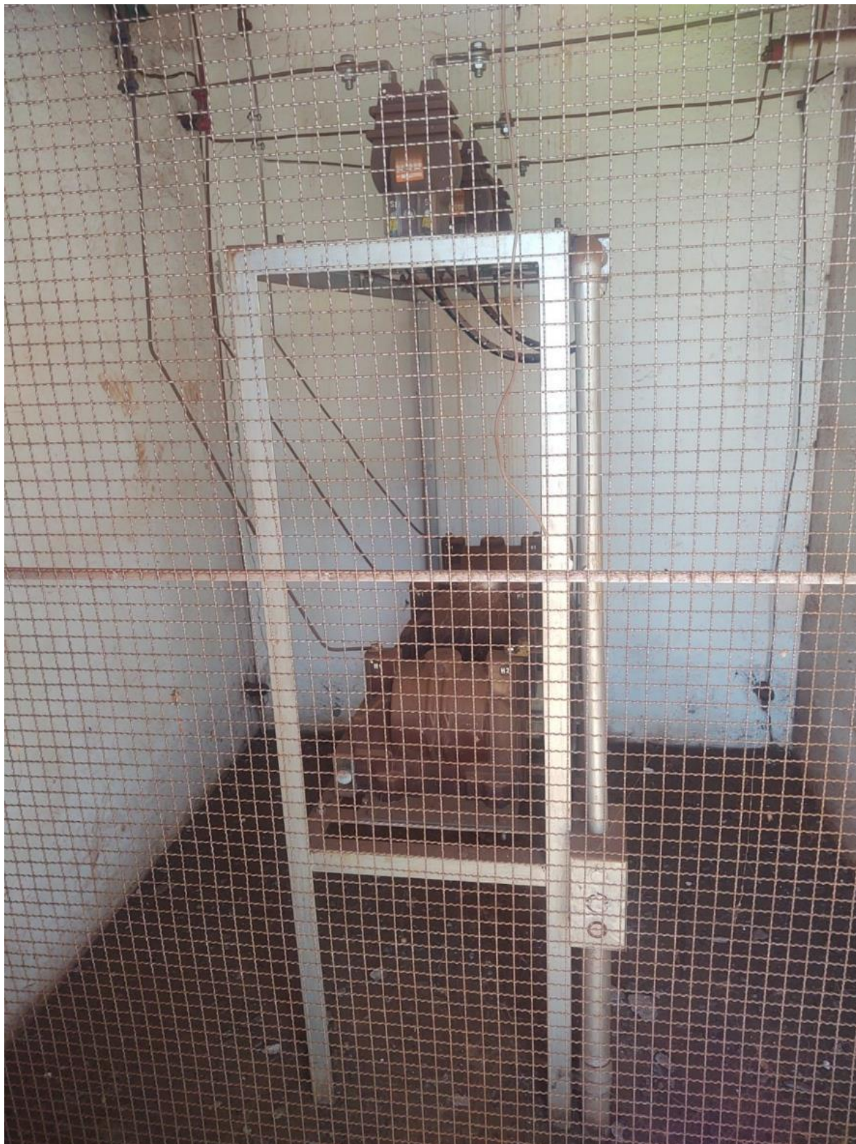
Figura 2. Grade de segurança e proteção
