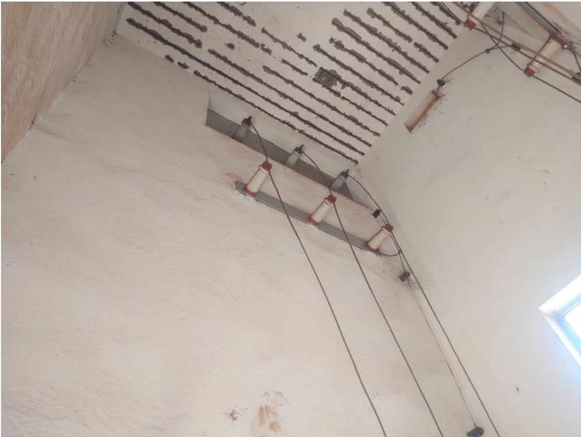
Figura 10. Barramento de cobre e para raio de proteção (entrada)
