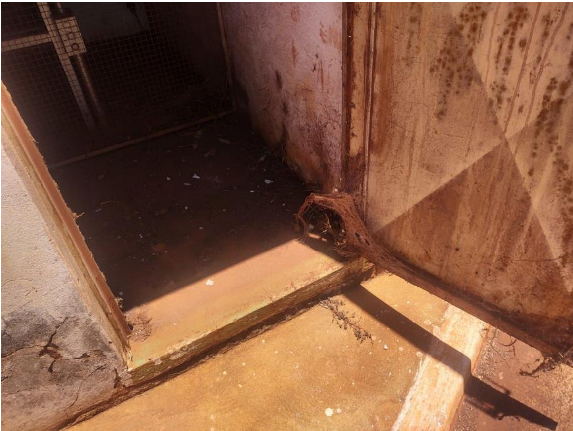
Figura 12. Detalha porta entrada cabine de medição
