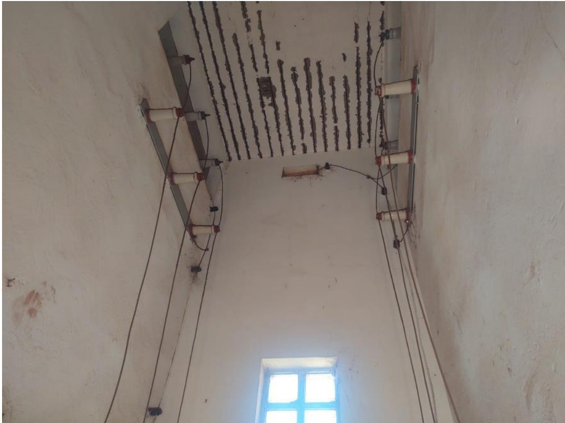
Figura 11. Barramento de cobre e para raio de proteção (entrada e saída)
