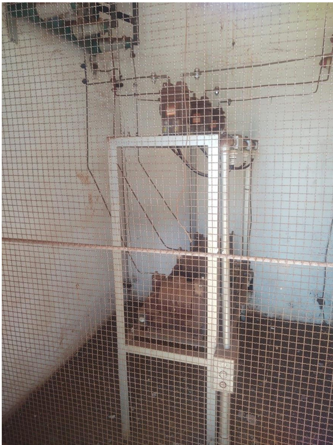
Figura 4. Conjunto de medição (transformador de corrente e tensão)
